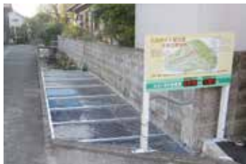
小水力発電設備の設置(小ヶ瀬井路)
